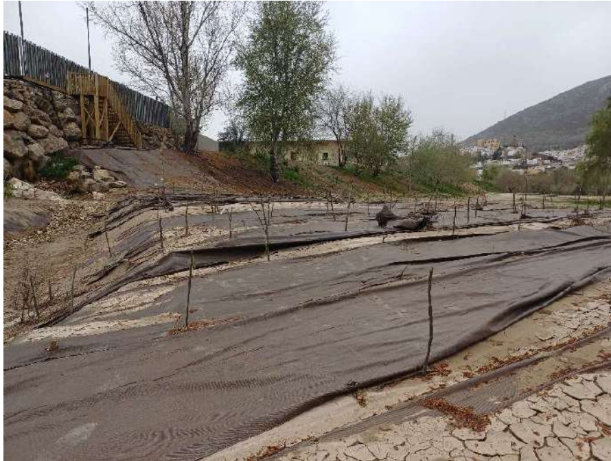
Figura 11. Geotextiles que cubren los brotes de Arundo con daños por haber sido levantados por el agua
